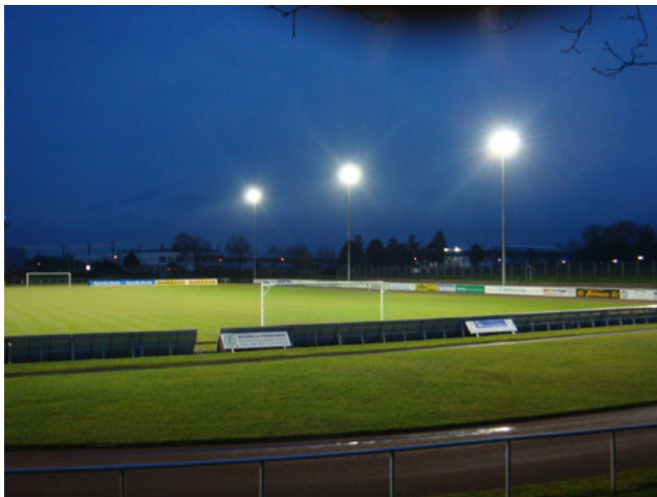
Trotz 25 Jahren wieder gut in Schuss: Die Flutlicht-Masten in Holzwickede
