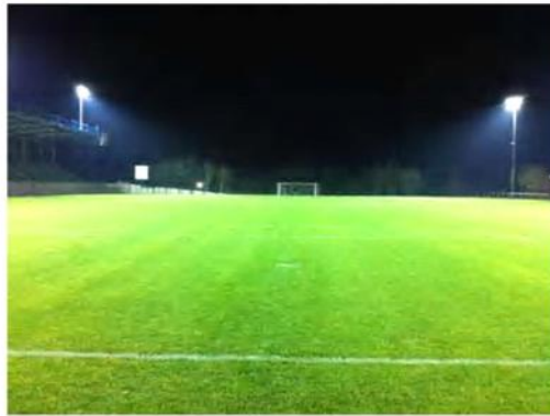
Mit der neuen Flutlichtanlage könnte der SV Rödinghausen schon jetzt im Profifußball spielen Alle Bilder: IBR-Flutlicht GmbH
